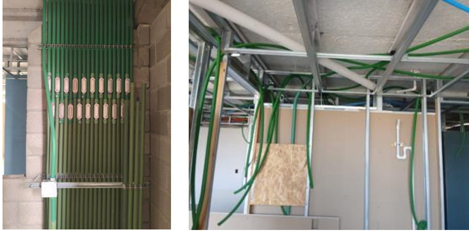
Ilustración 7. Canalizaciones eléctricas de los departamentos y sus acometidas
