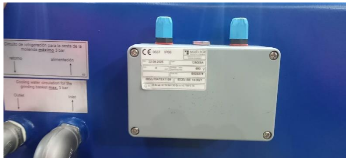
Ilustración 16. Cajas de distribución superior
